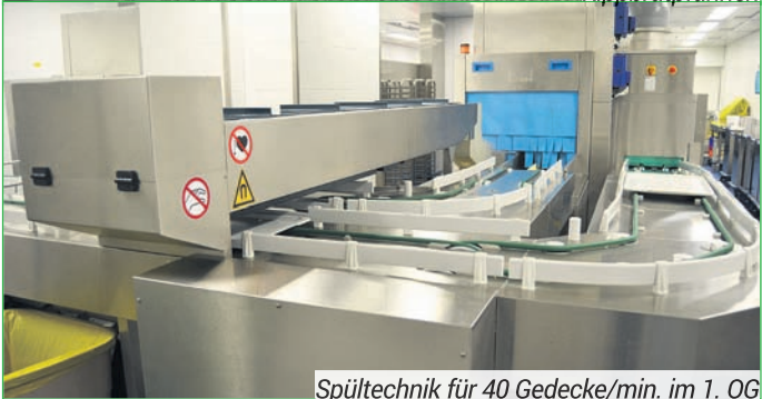
Spültechnik für 40 Gedecke/min. im 1. OG
